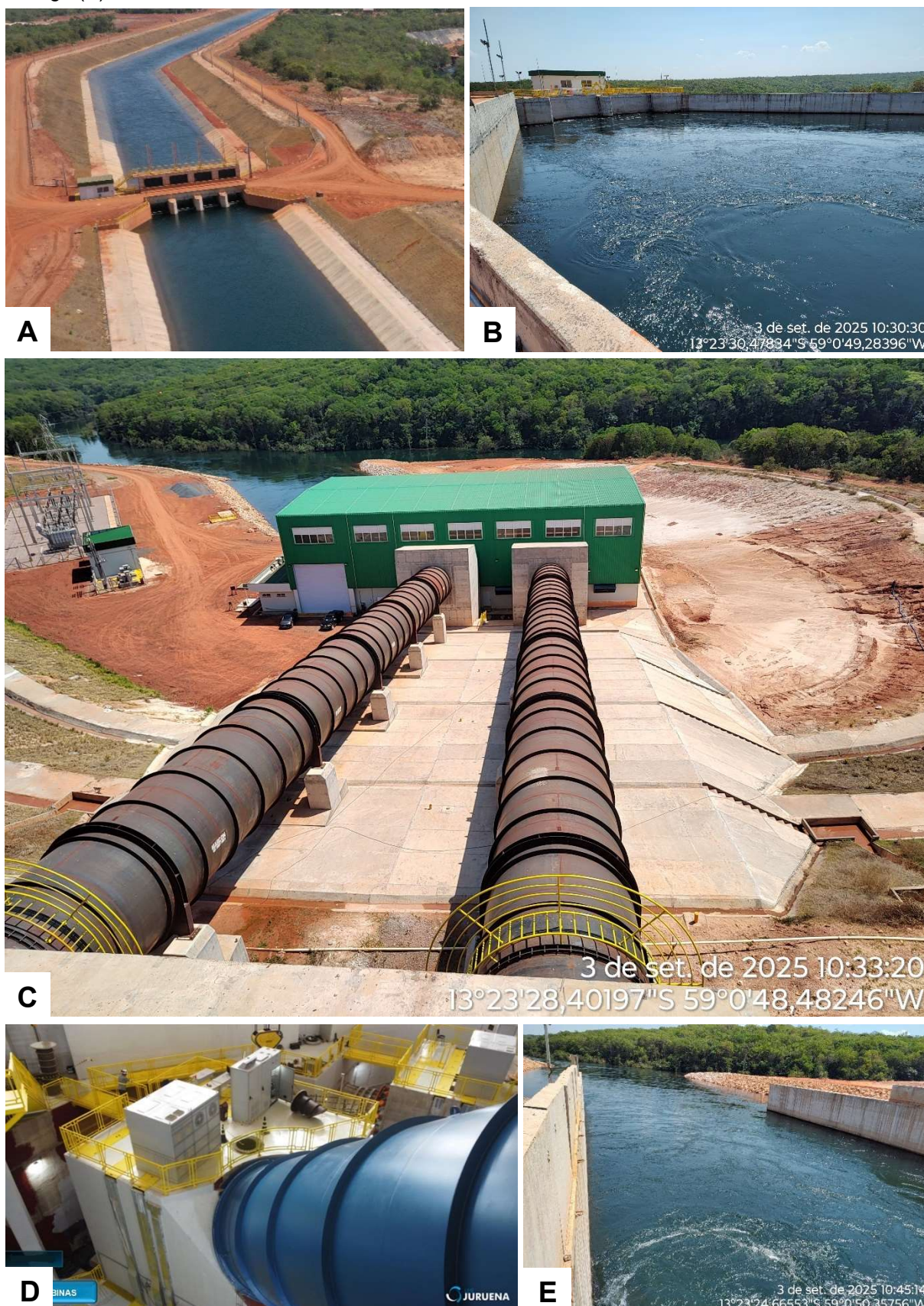
Figura 10. Vistas de estruturas hidráulicas da UHE Juruena, Campos de Júlio e Sapezal – MT. Estrutura de controle de vazão (A), câmara de carga (B), condutos forçados (C), turbinas (D) e canal de fuga (E).
